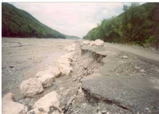
Рис. 15. Правый берег р. Гизельдон ниже устья р. Геналдон. Разрушение полотна автодороги прорывным паводком 16 июня 2003 г. Фото Э. Запорожченко
