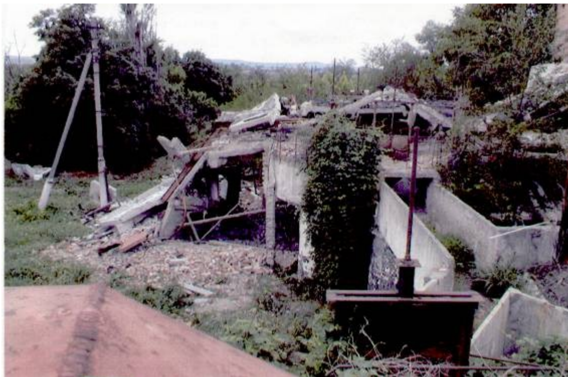
Рис. 8. Разрушенные биологические очистные здания и сооружения в г.Грозном, подлежащие восстановлению по проекту института
