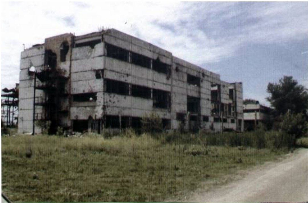
Рис. 7. Разрушенные здания системы биологической очистки стоков в г. Грозном, подлежащие восстановлению по проекту института
